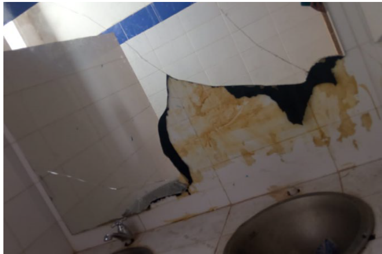
Figura 10. Evidencia de falta de mantenimiento y limpieza
