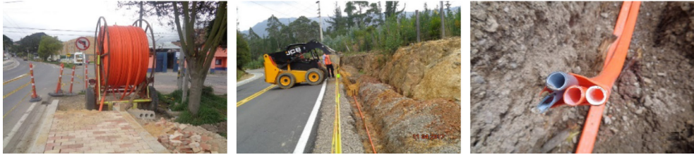
Figura 2. Instalación de redes FO del Concesionario Perimetral Oriental de Bogotá S. A. S., 2021 Fuente: registro y elaboración propia.
