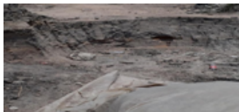
Figura 9. Daños al suelo
