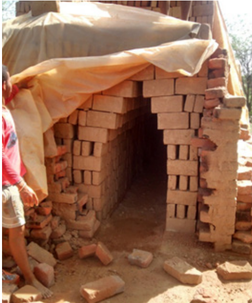
Figura N° 3: Carga del horno
